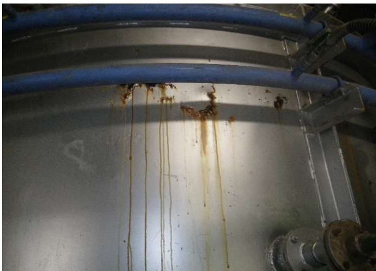
写真12 4号焼却炉 ガス冷却室ケーシング 腐食、穴あき
