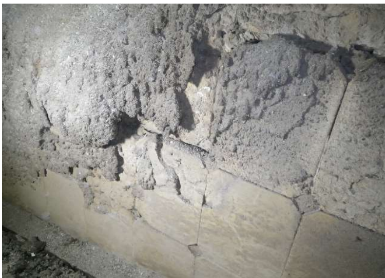
写真6 1号焼却炉 燃焼帯 クリンカ防止ライナー部欠落
