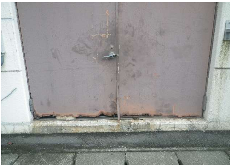
写真27 誘引送風機室入口扉 下部腐食
