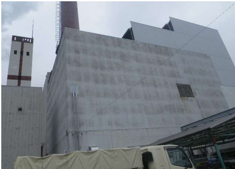
写真26 建屋外壁塗装 劣化
