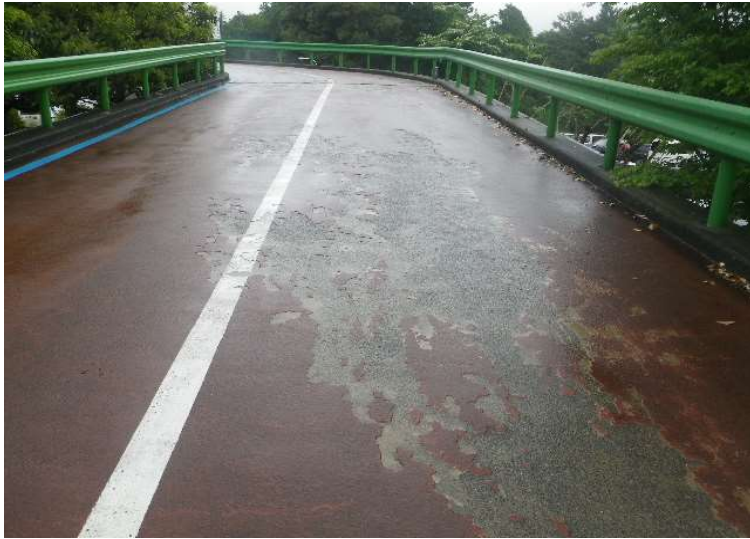
写真1 搬入退出路 路面ノンスリップ塗装の 剥がれ
