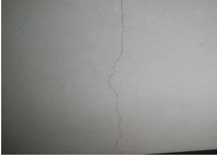
写真25 ごみクレーン操作室通路 側壁 亀裂
