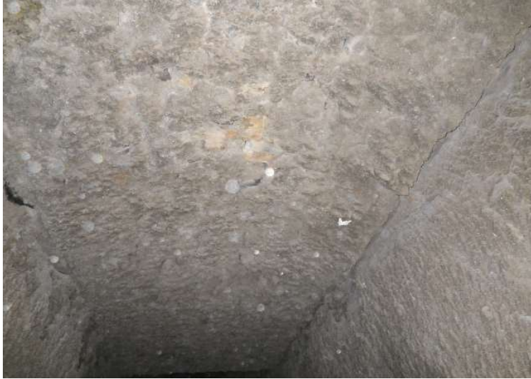
写真7 2号焼却炉 燃烧帯 天井耐火物一部欠落
