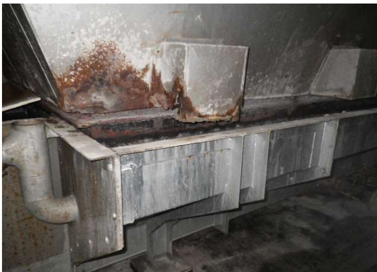
写真21 1号焼却炉 ガス冷下コンベヤ 腐食
