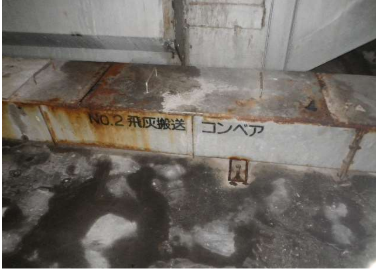
写真22 No. 2飛灰搬送コンベヤ ケーシング腐食
