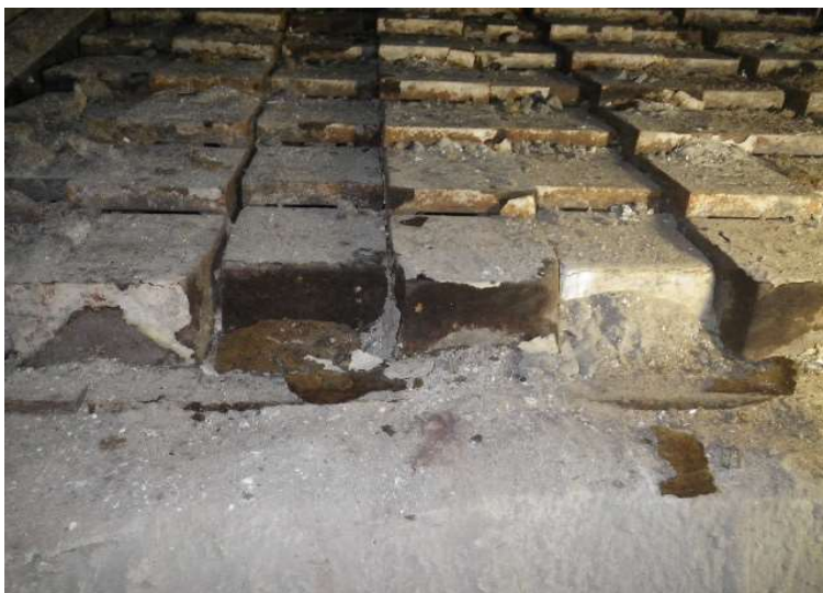
写真9 2号焼却炉 燃烧火格子 一部焼損
