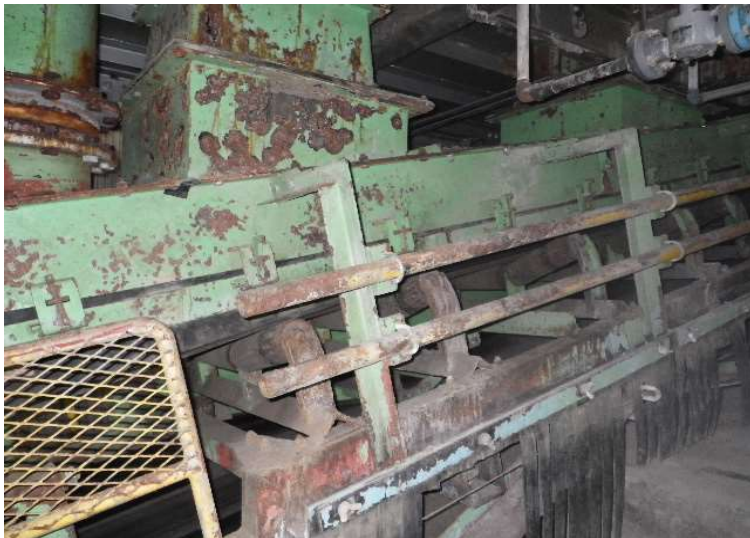
写真23 飛灰固化物搬送コンベヤ 腐食
