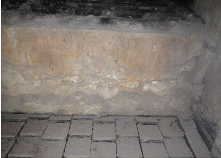
写真4 4号焼却炉 乾燥帯 段差部耐火物の一部損傷
