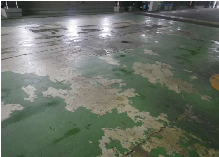
写真2 プラットホーム 床面防塵塗装の剥がれ等
