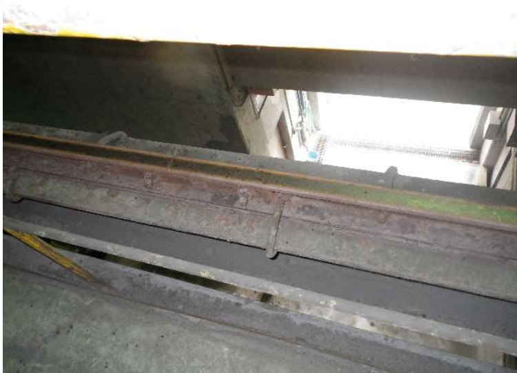
写真24 灰クレーン レール 摩耗
