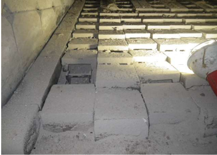
写真10 4号焼却炉 燃焼火格子 一部焼損
