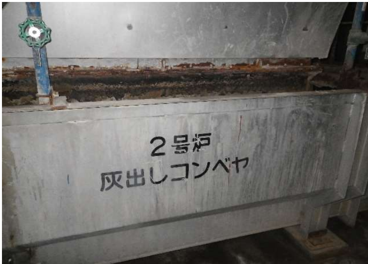
写真20 2号焼却炉 灰出しコンベヤ 腐食
