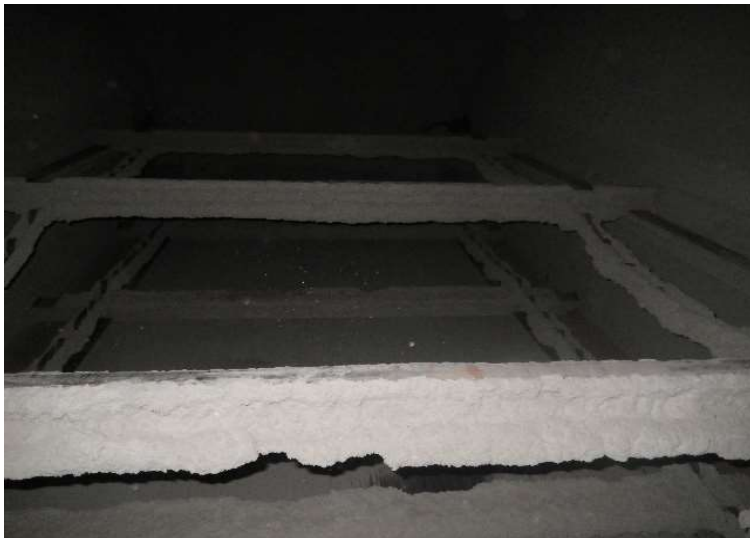
写真14 4号焼却炉 バグフィルタ下部 スクレーパ等劣化
