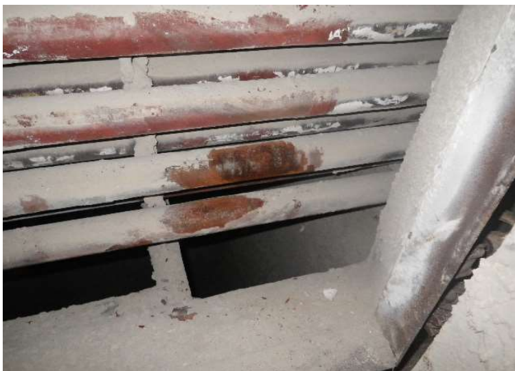
写真18 4号焼却炉 燃烧用空気予熱器 伝熱管腐食、穴あき
