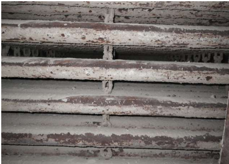
写真17 1号焼却炉 燃烧用空気予熱器 伝熱管腐食、穴あき
