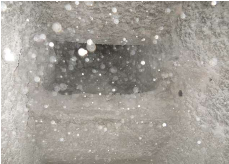
写真8 1号焼却炉 炉出口部 ダスト堆積による煙道 閉塞
