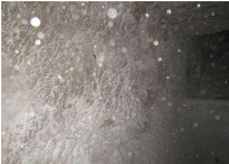
写真5 2号焼却炉 燃焼帯 左側壁耐火物の一部欠落
