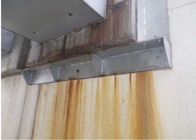
写真19 3号焼却炉 煙突手前煙道 腐食
