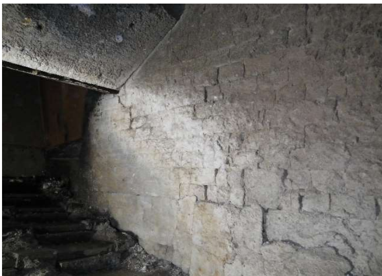
写真3 2号焼却炉 乾燥帯 左側壁レンガの摩耗
