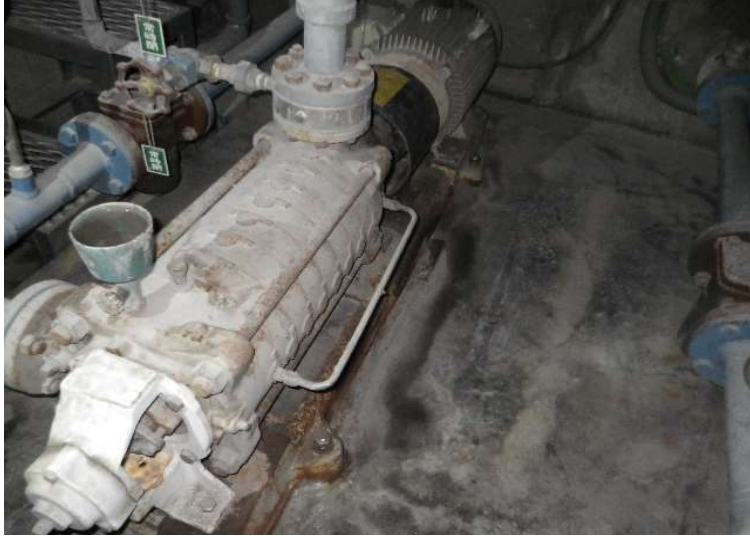
写真13 3号焼却炉 水噴射ポンプ 電動機耐用年数超え
