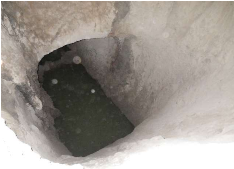
写真11 4号焼却炉 ガス冷却室内部耐火物 経年劣化
