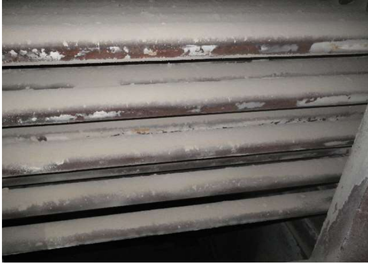
写真16 4号焼却炉 温水用空気予熱器 伝熱管腐食
