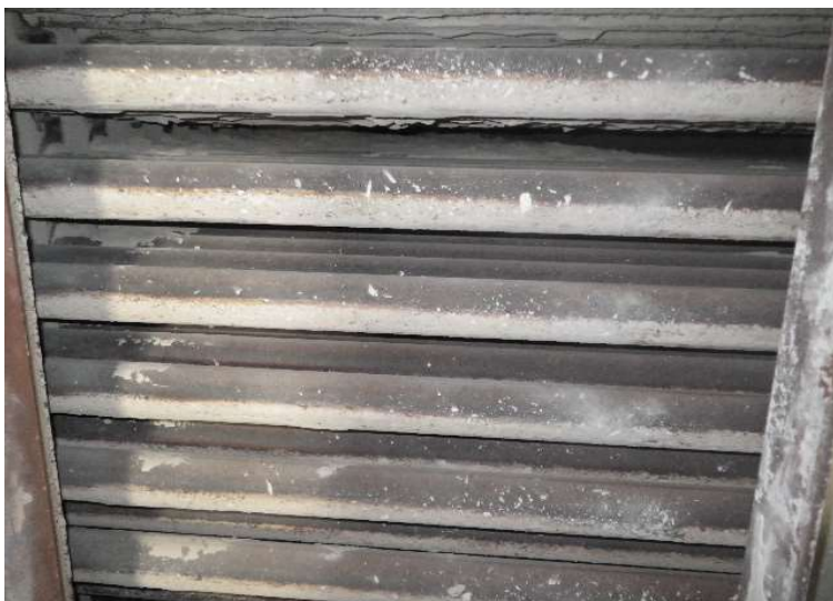
写真15 1号焼却炉 温水用空気予熱器 伝熱管腐食
